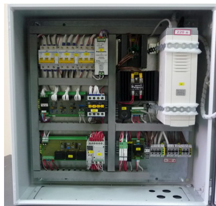
Шкаф системы с открытой дверцей.
